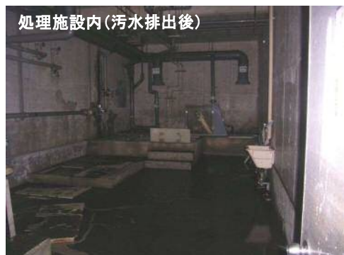
平野農業集落排水処理施設
